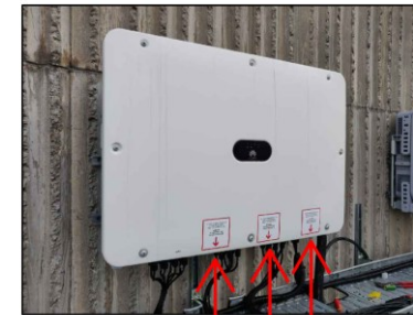
DC-seitiges Abschalten: Durch kippen der Kippschalter an den Wechselrichtern auf OFF (0) wird die Anlage DC-Seitig ausgeschaltet. (3 je WR) Achtung: Die DC-Leitungen zwischen den Modulfeldern und den Wechselrichtern sind immer spannungsführend!
