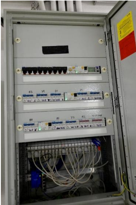
Sicherungskasten mit Fehlerstromschutzschalter und Leitungsschutzschalter
