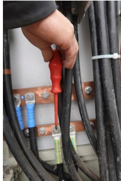
Zuleitung zur DC- Ladestation
