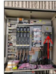
AC-seitiges Abschalten: Ausschalten des LS des ENS im PV-AC-Verteiler am Dach. Damit ist die Anlage AC-Seitig getrennt.
