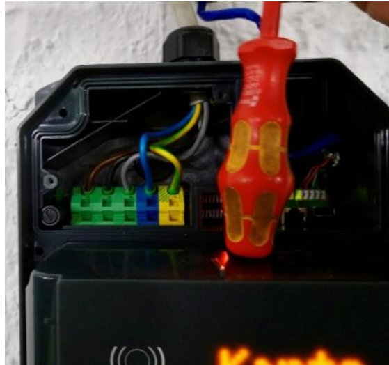
Zuleitung zur AC-Ladestation
