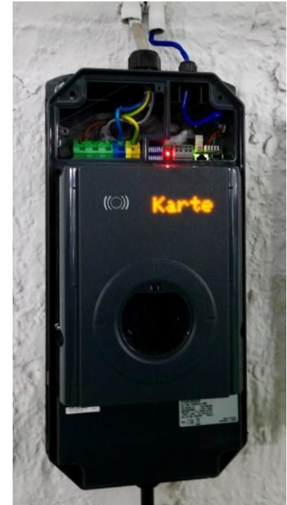
Anschluss teil einer AC-Ladestation
